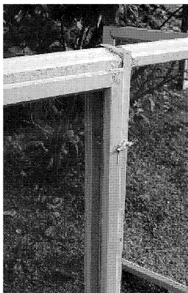
Figur 8.2 Överfalsade innerbågar utan gångjärn.
